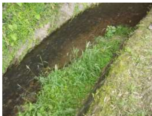
水路内に堆積した土砂
