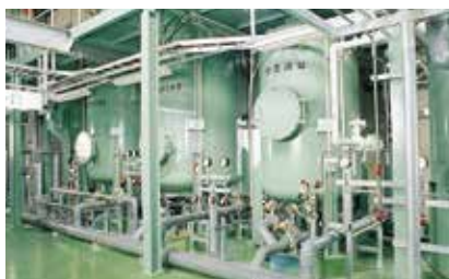
高度処理設備
