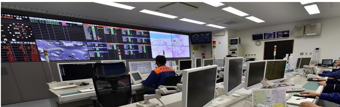
現在の消防指令センター
