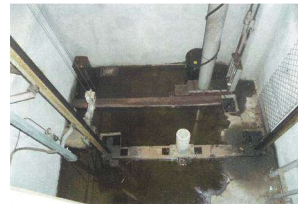
工場棟昇降機オイル漏れ状況↓
